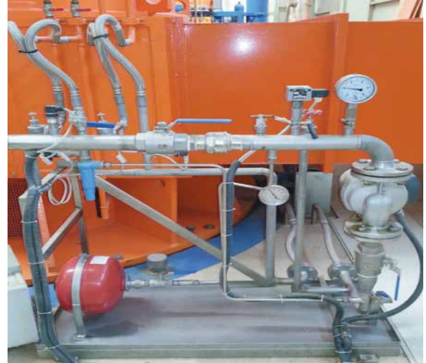
Resim-2 Kapalı Devre Soğutma Sistemi
