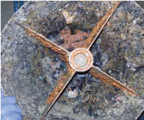
Resim-1 Açık Devre Soğutma Sisteminde tıkanan Filtre
