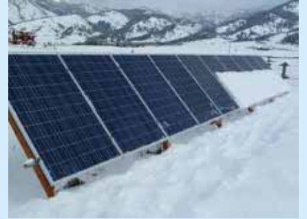
PV Panel Uygulaması Kaynak: www.builtitsolar.com
